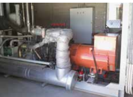
Centrale de co-génération
