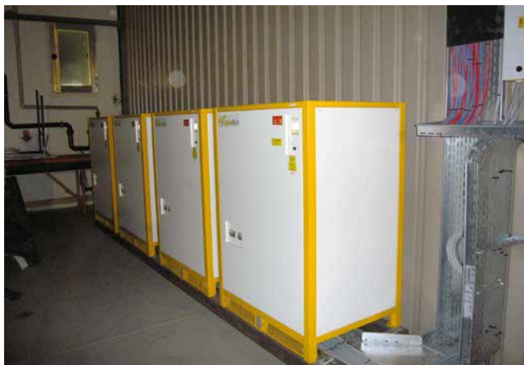
Des onduleurs au sol
