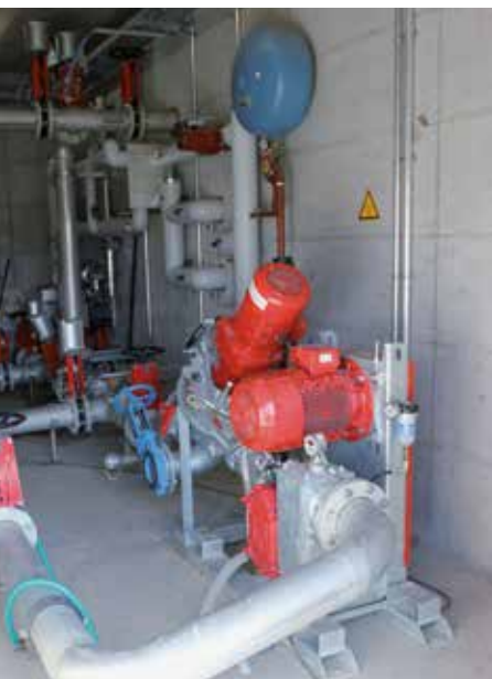
La station de pompage
