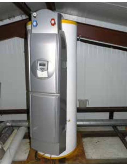
Le ballon de stockage de l'eau chaude
