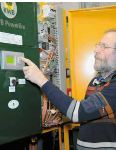
Centre de commandes de la chaudière
