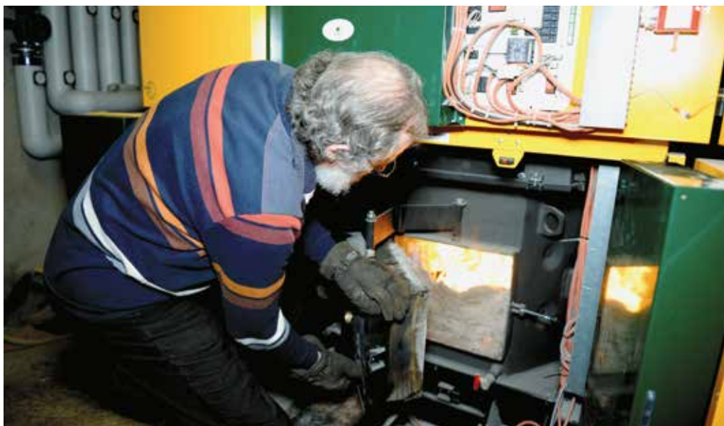
Foyer de la chaudière à plaquettes
