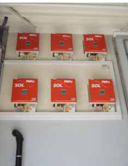
Des onduleurs fixés en hauteur
