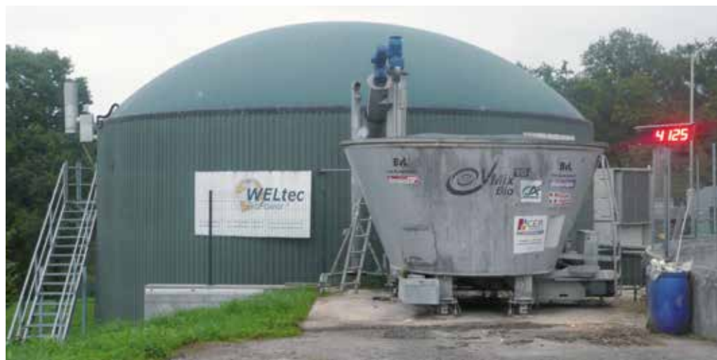
L'installation de biogaz avec le digesteur et le post-digesteur
