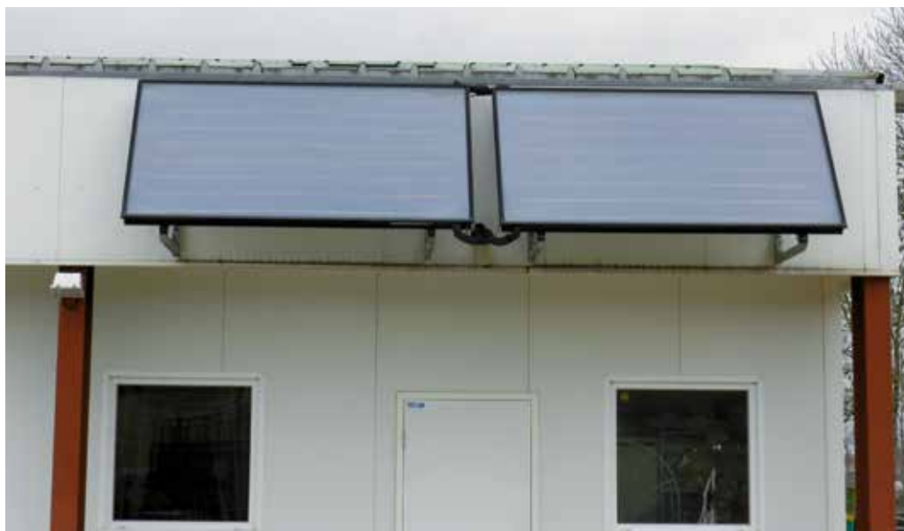
Les panneaux solaires thermiques
